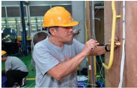
รูปที่ 1.5 งานไฟฟ้า
