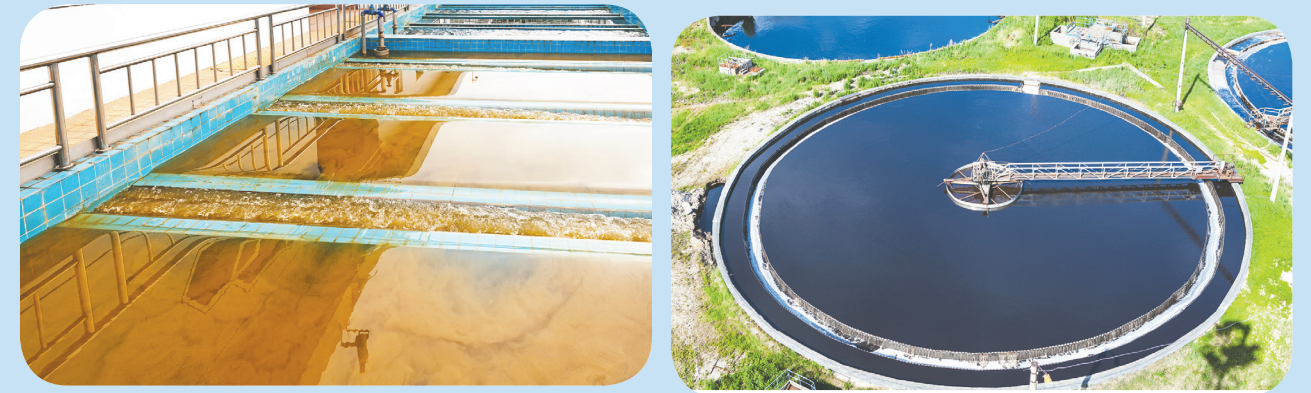
▲ ภาพที่ 5.25 ขั้นตอนหนึ่งของการบำบัดน้ำเสียโดยการทำให้เกิดการตกตะกอน
