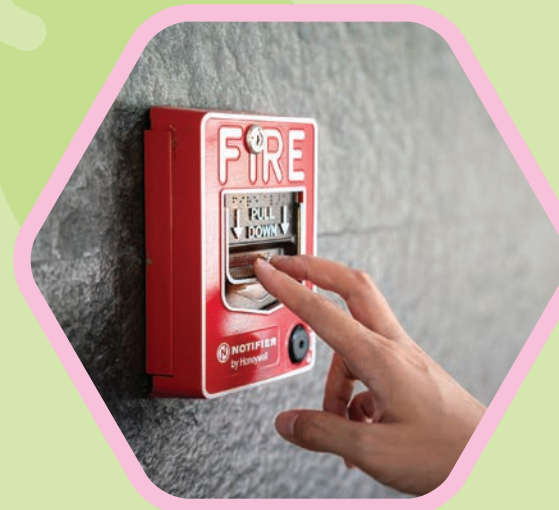
เสียงสัญญาณเตือนไฟไหม้
