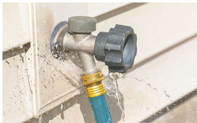
▲ ภาพที่ 5.10 ตรวจสอบรอยรั่วของท่อน้ำในบ้าน หากพบรอยรั่วต้องรีบซ่อมแซม ที่มา : คลังภาพ อจท.
