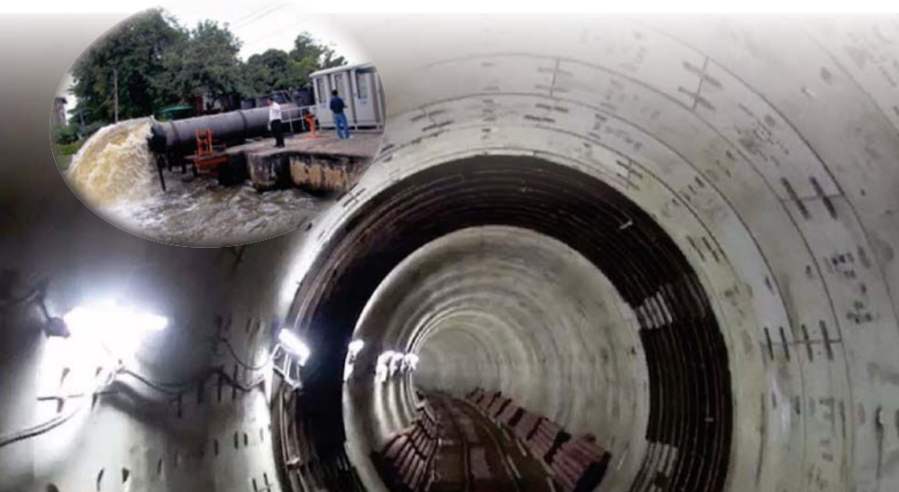
รูปที่ 1.24 อุโมงค์ระบายน้ำขนาดใหญ่ที่บางซื่อ กรุงเทพมหานคร และสถานีสูบน้ำของกรมชลประทาน
